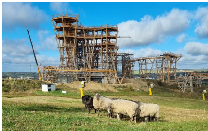
Fig.7 Widok ogólny ciągu napowietrznego z punktem widokowym w Kurzętniku (fot. G. Blaszkowski)
