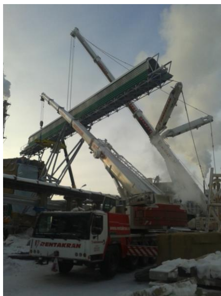
Rys. 10. Demontaż trawers przy pierwszym segmencie - widoczna realizacja schematu montażowego pokazanego na rys. 7
